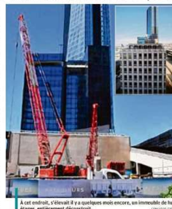
À cet endroit, s'élevait il y a quelques mois encore, un immeuble de huit étages, entièrement déconstruit. /PHOTOS D.R. ET L.P.
