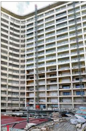
La réfection des balcons et de leurs garde-corps est au cœur de la polémique. /PHOTO GEORGES ROBERT
