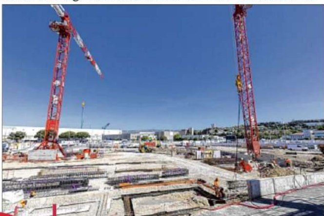
Le nouveau data center MRS4 devrait être livré au premier trimestre 2020, offrant ainsi 6 700 m 2 d'espaces équipés pour les clients hébergés. /PHOTOS FRÉDÉRIC SPEICH
