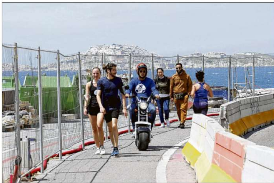
La troisième phase des travaux, qui s'étend vers la pointe du Roucas-Blanc, a débuté en octobre dernier. /PHOTO DAVID ROSSI
